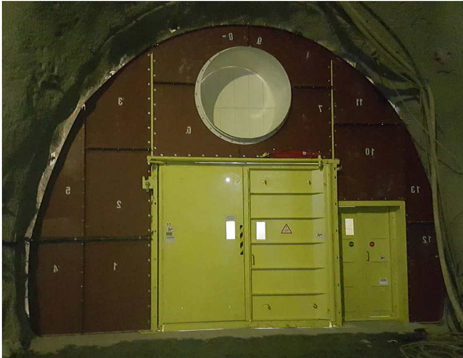
Abbildung 7 Rauchschott mit gegenläufigem Tor beim konventionellen Vortrieb (Quelle: Wettertechnik GmbH)
